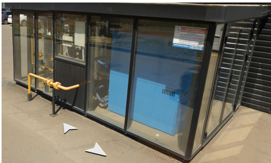
Рисунок 1. БМК в стеклянном ограждении
